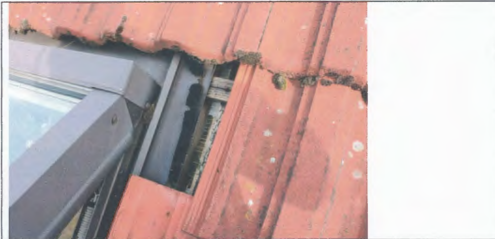
Bild 7: Fehlende Ziegel am Dachfenster, defekte Unterspannbahn
