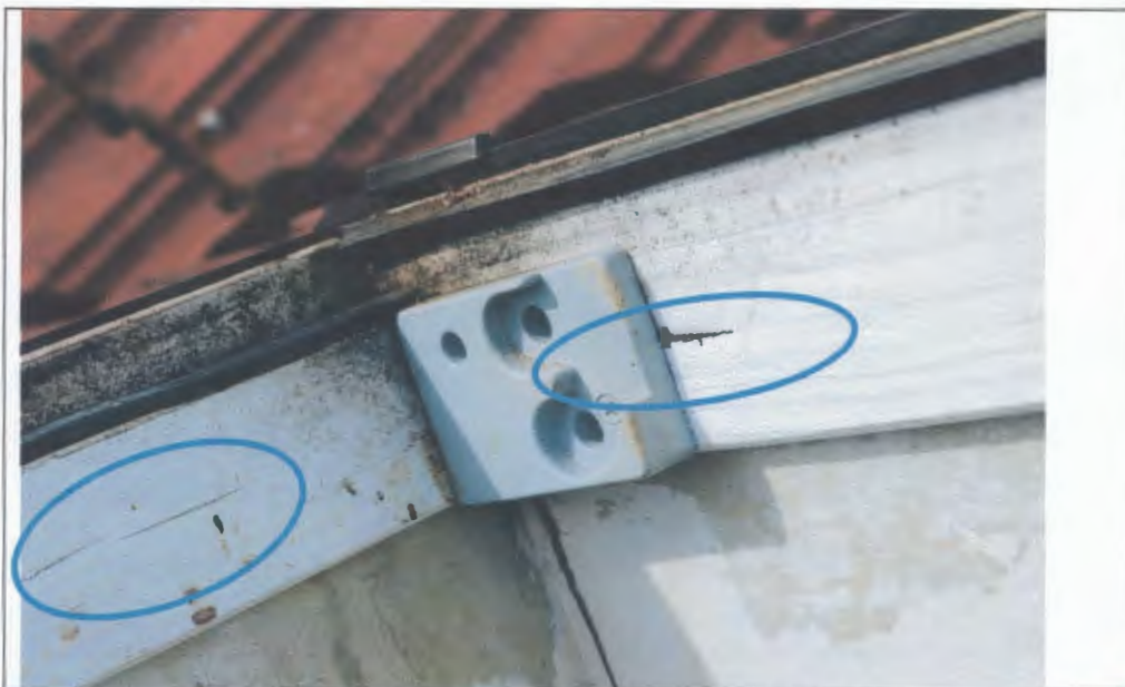
Bild 6: Untere Ecke des Fensters, Holz infolge Fäule abgebaut
