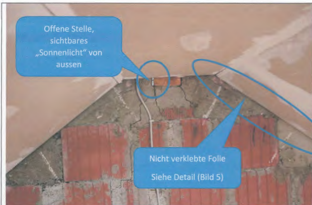
Bild 4: nicht verklebte Folie, offenes „Loch“ an Balken
