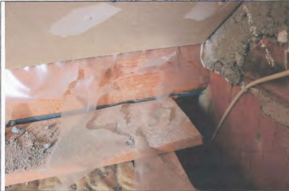
Bild 3: spröde, brüchige „Dampfsperre“ im Fusspfettenbereich
